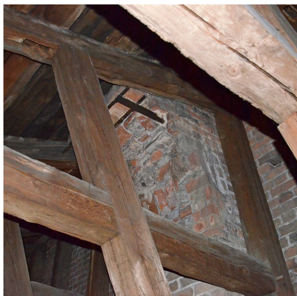
7. Włocławek, katedra pw. Wniebowzięcia NMP, strych nad nawą południową, relikty łuku oporowego z widocznymi klińcami nasady łuku w trzonie przypory. Fot. P. Pajor
